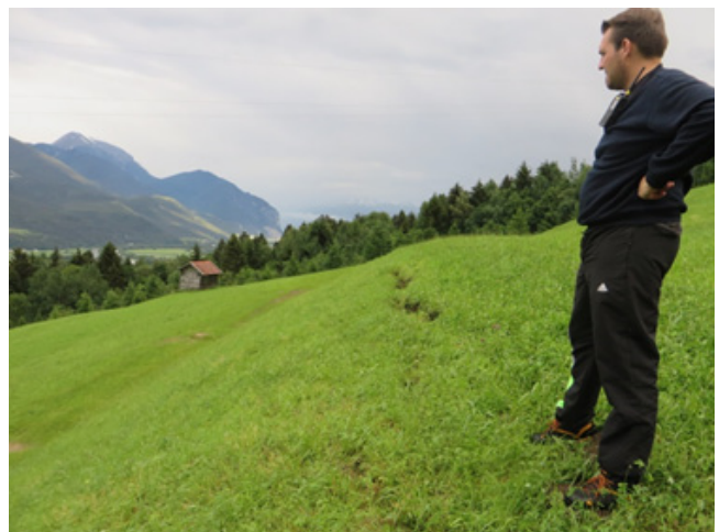
Böschungsbruch bei Kirchmair Wolfgang: starker Oberflächenwassereintrag, Durchriss der Böschung an der Krone über nahezu die gesamte Breite der Flur – Hinweis meinerseits die Risszone abzudecken, um Oberflächenwassereintrag zu vermeiden und nach Aufrocknung unmittelbar zu sanieren.
