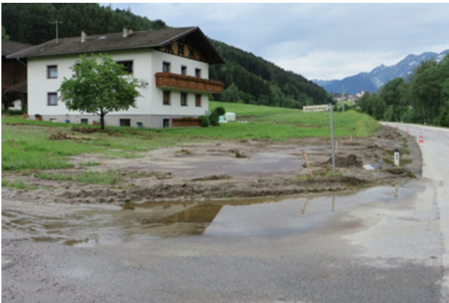
Situation Angerweg am 08.06.2015 nach ersten Aufräumungen durch BBA: Die Gerinne-Durchlässe zum Gießen sind auch bei durchschnittlichem Wasseranfall überlastet und neigen aufgrund des geringen Durchmessers immer wieder zum Verklausen; Maßnahmen seitens der Straßenverwaltung sind erforderlich.
